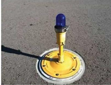
Figure A10.10. Taxiway Edge Light
